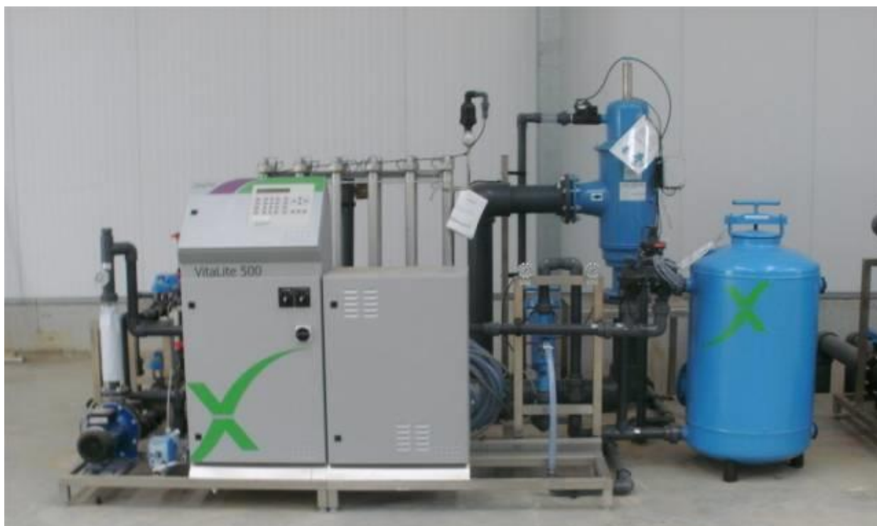
Figure 46 : installation de pompage des eaux pluviales
