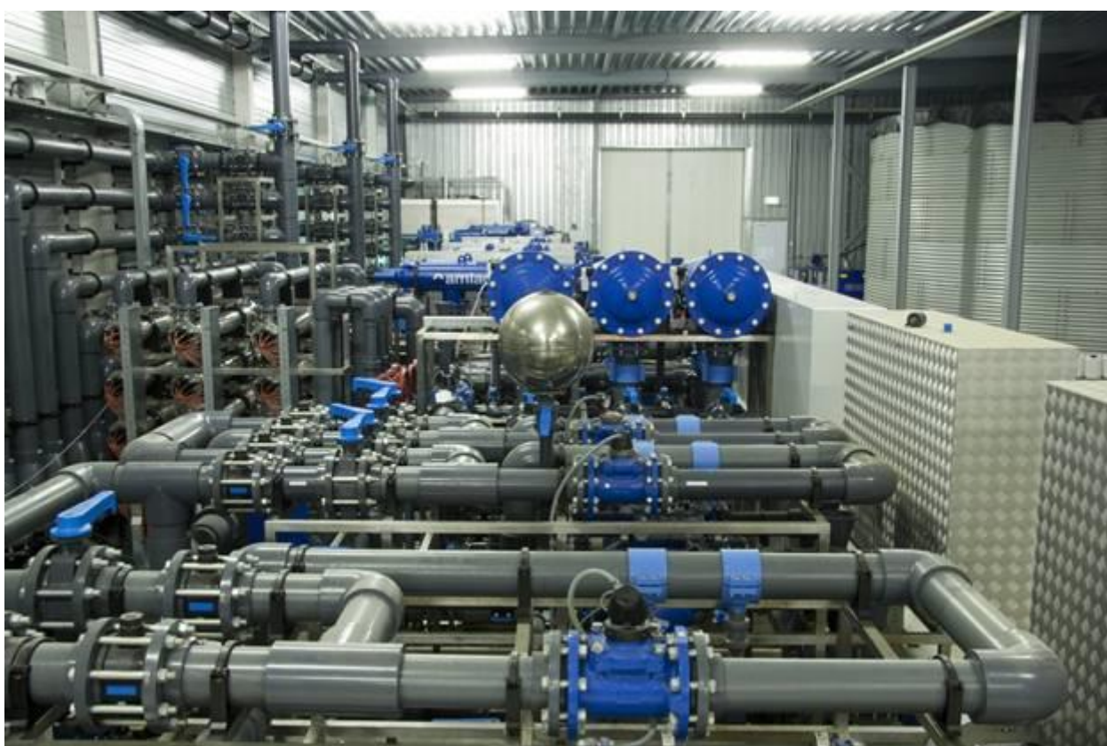
Figure 48 : Installation de traitement des eaux d'arrosage
